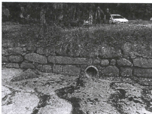
Figura 5. Manilha (águas pluviais) com saída para a praia.
