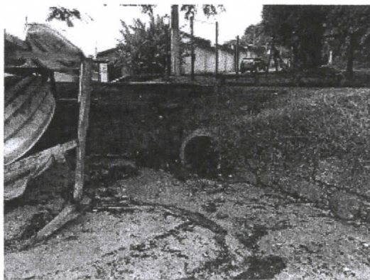
Figura 6. Manilha (águas pluviais) com saída para a praia.
