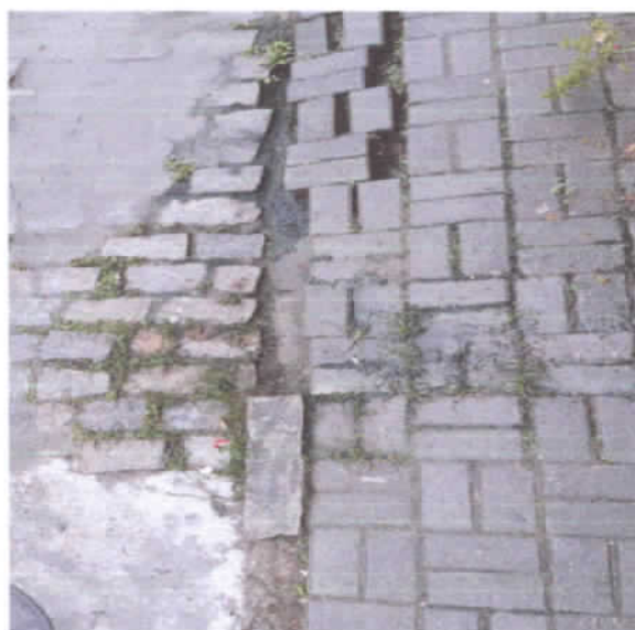
Foto atual do vazamento de esgoto na calçada
